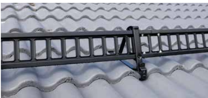
Bild 22. Snörasskydd Safe monterad på tak.
