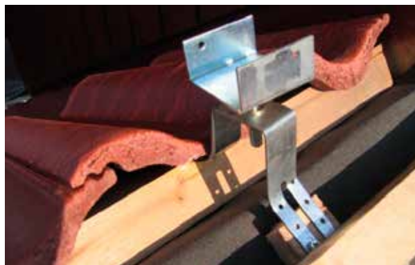
Monteringsbild 5. Lägg dit takpannorna och passa in dessa så de ligger bra, fäst pannorna.
